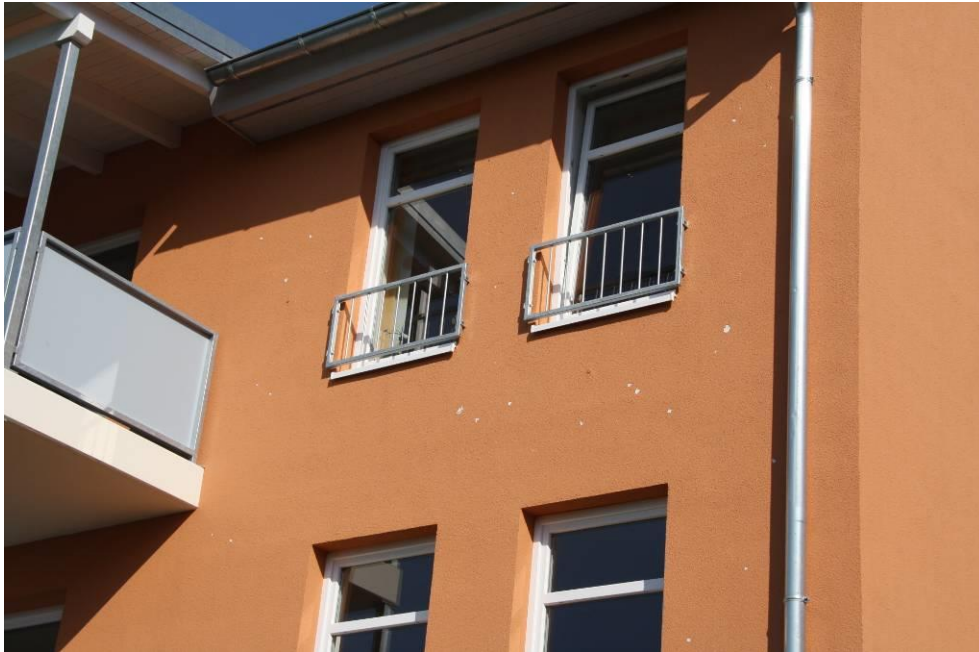
Foto 2 – Fassade mit Putzschäden
